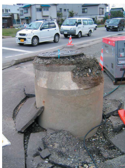
(5) マンホールの隆起
