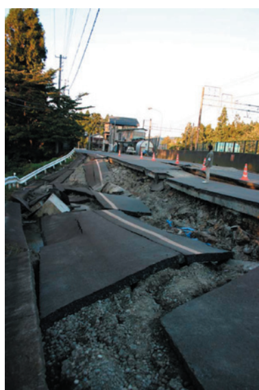
(2) 重力性崩壊に伴う割れ目
