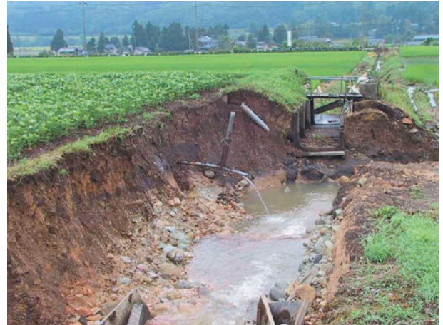
写真4 洪水により流された水路（下田村）（写真提供：三条農地事務所）
