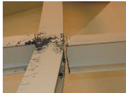
写真 35 川口小学校 H 型鋼 ブレースの破断
