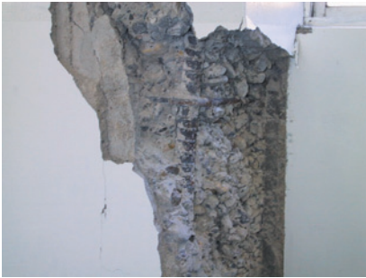
写真 22 写真 21 の詳細（ジャンカが認められる）
