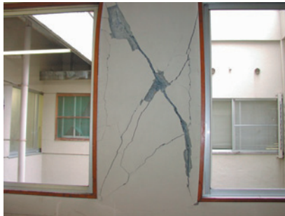
写真 26 十日町病院の2F長辺方向柱のせん断破壊「高橋義道氏（高橋構造企画設計）撮影」
