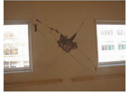
写真9 2F 北側構面の柱のせん断破壊（Ⅳ）
