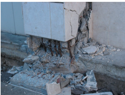
写真 28 建物Aの柱脚の被害
