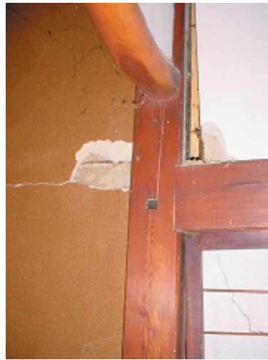
写真.28 込み栓における柱割れ (No.5)
