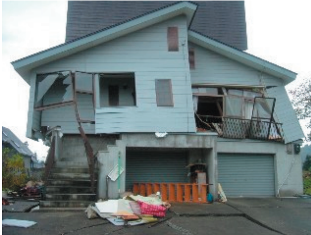
写真.2 大破した高床基礎の在来軸組住宅
