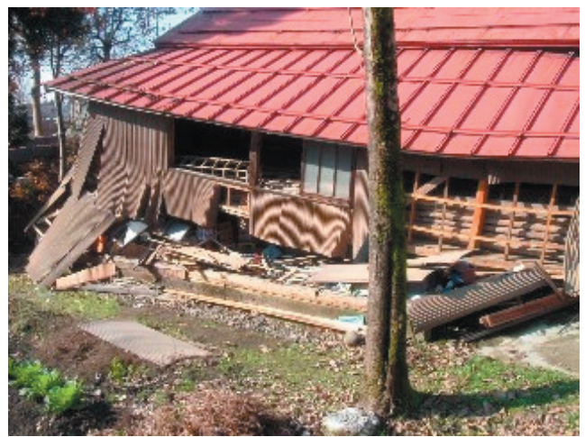
写真.5 倒壊した作業場
