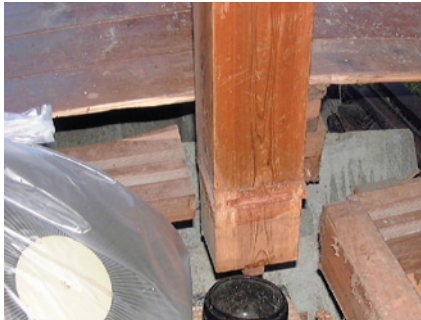
写真.15 土台と柱のずれ
