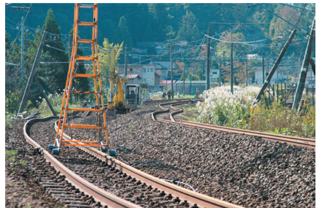
写真-4 JR 信越線の被害 (越後広田駅付近)
