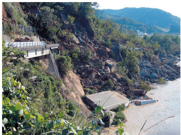
写真-7 斜面崩壊に伴う県道橋の落下 (長岡市妙見)
