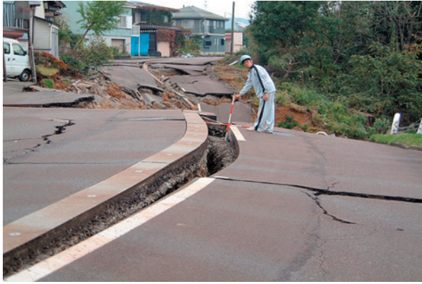
写真-12 高町団地の被害(長岡市)
