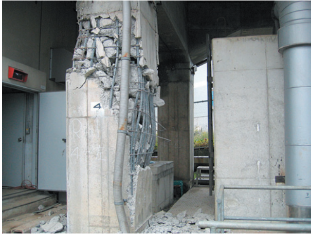
写真-2 上越新幹線和南津高架橋柱のせん断破壊
