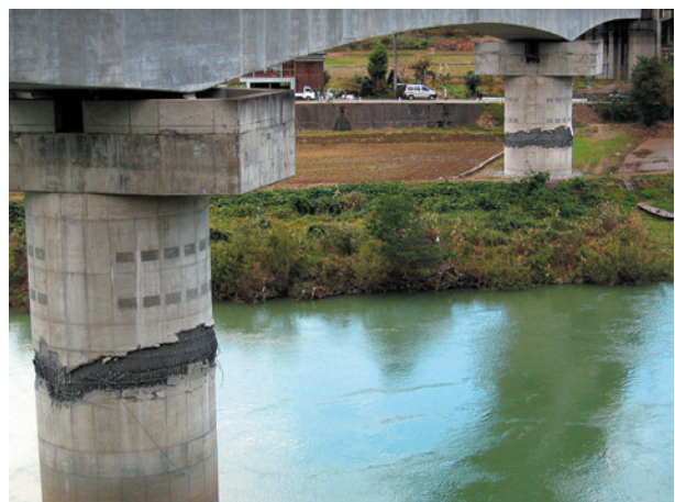
写真-1 上越新幹線魚野川橋梁の被害(川口町)
