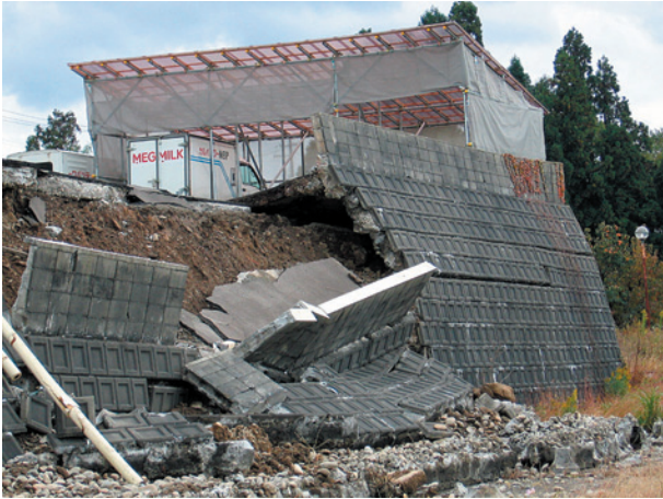
写真 -13 ブロック積み擁壁の崩壊 (小千谷市)
