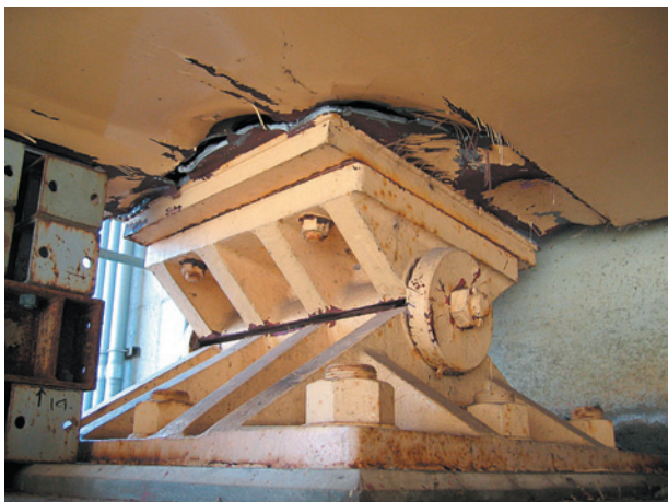
写真-6 関越道越後川口橋固定支承周辺の損傷
