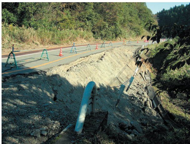
写真-10 道路盛土の崩壊例 (柏崎市)
