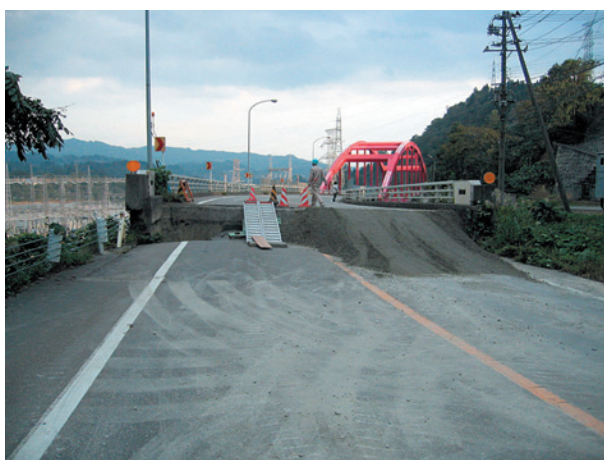
写真-9 橋梁取付け部の段差 (国道 117 号山辺橋)
