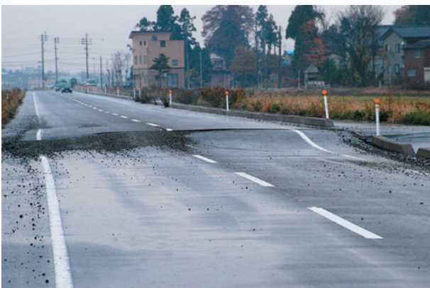
写真 -14 液状化による路面の沈下 (長岡市)
