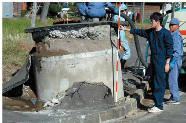
写真 -16 下水道マンホールの浮き上がり (柏崎市)
