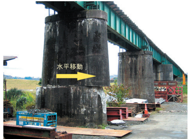
写真-3 JR 飯山線魚野側橋梁の橋脚被害
