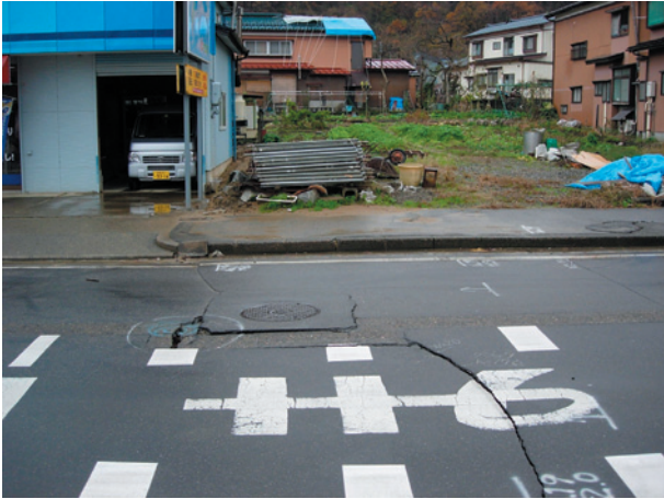
第 9 図. 道路に生じた亀裂（嶺崎 1 丁目）
