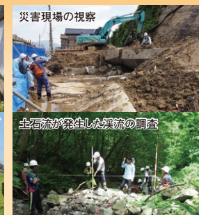
災害現場の視察 土石流が発生した渓流の調査 防災系演習及び実習
